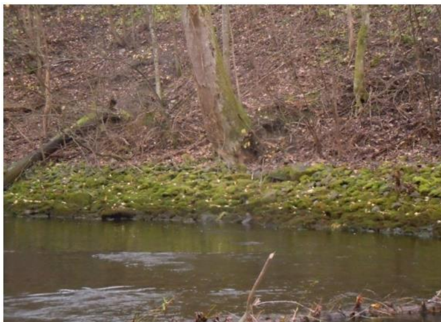
Figur 9: Brant slänt med erosionsskydd av utlagd sprängsten. Mitt emot "Snickarudden", fotoriktning söder (Sweco, 2015).
