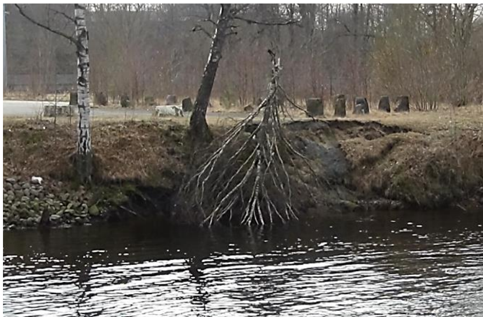
Figur 12: Erosionsskada/släpp strax nedströms bron över Sävån, mitt emot utloppet till kraftverksfåran.
