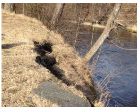
Ytlig erosionsskada där släpp skett, mitt emot Vattenkraftverkets utlopp i Säveån.
