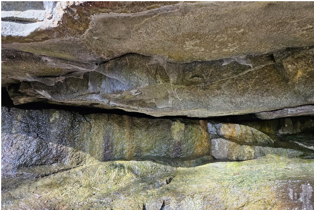
Figur 7: Skrevor under överhäng.
