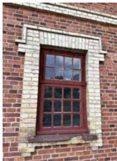
Ursprungligt småspröjsat 2-lufts-fönster med solbänk (fönsterbleck) av gjutjärn (foto från Kulturmiljöunderlag, Acanthus).
