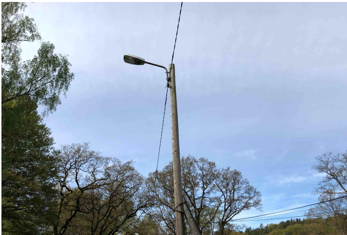
Figur 8-5. Befintliga lyktstolpar och armaturer utmed William Gibsons väg.
