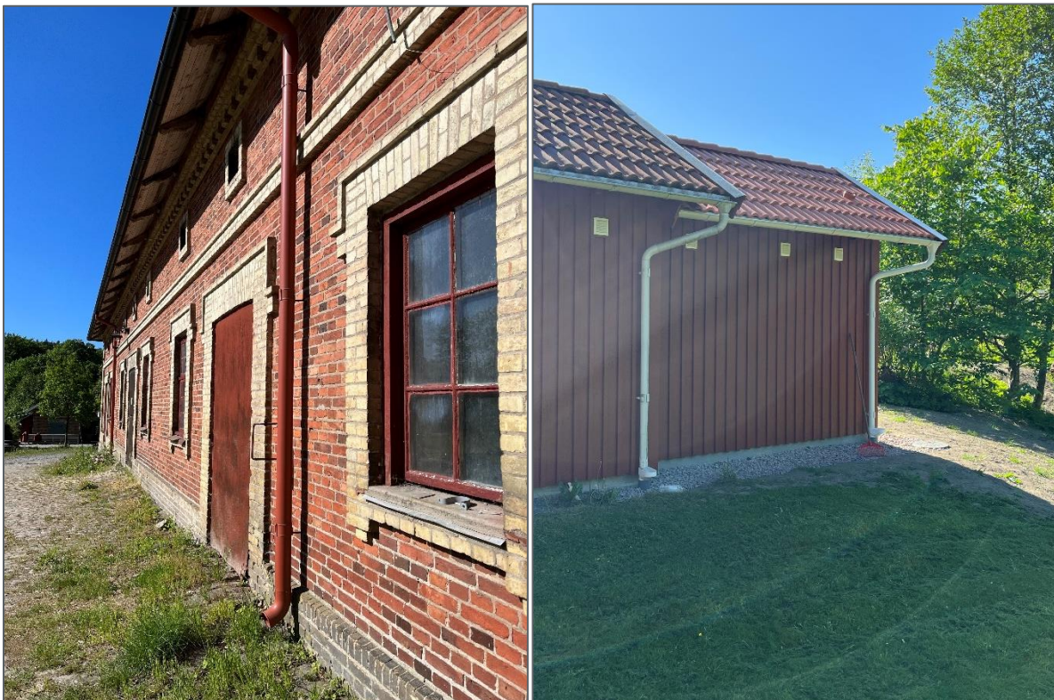
Figur 17. Stuprör och utkastare på byggnader inom planområdet. (Foto: Norconsult)
