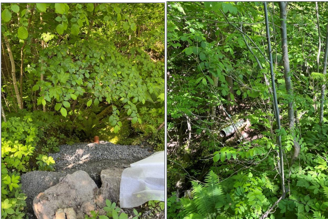
Figur 19. Dagvattenutlopp till dike/bäck strax väster om planområdet. (Foto: Norconsult)
