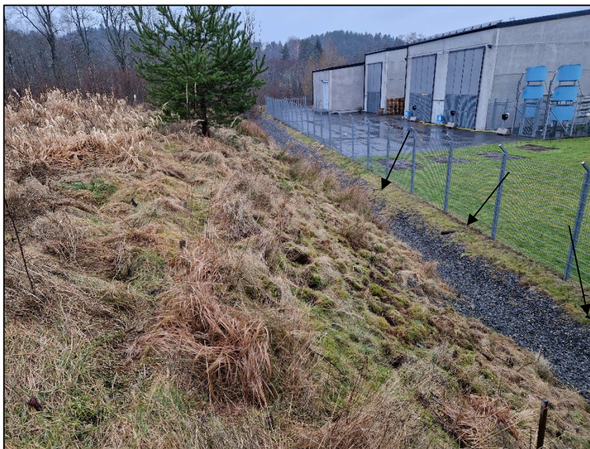
Figur 6. Bild från befintliga diket från en annan vinkel. Till diket ansluts flera dräneringsledningar från grannfastigheten/befintlig transformatorstation. Svarta pilar visar var flera inlopp till diket hittades. Bildkälla: COWI.
