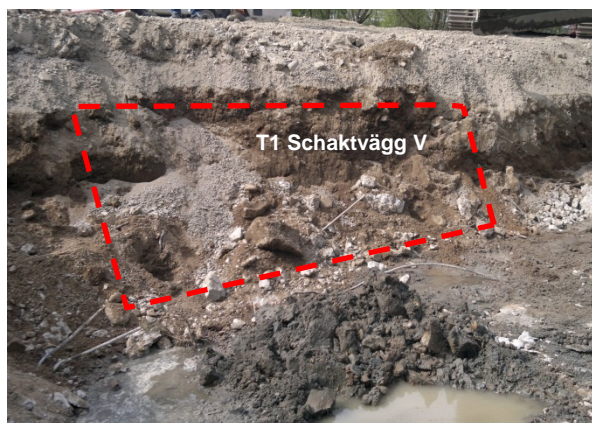
Figur 5. Kontrollprov i schaktvägg (2x6 m) där det tidigare konstaterats fri fas isolerolja (T1).
