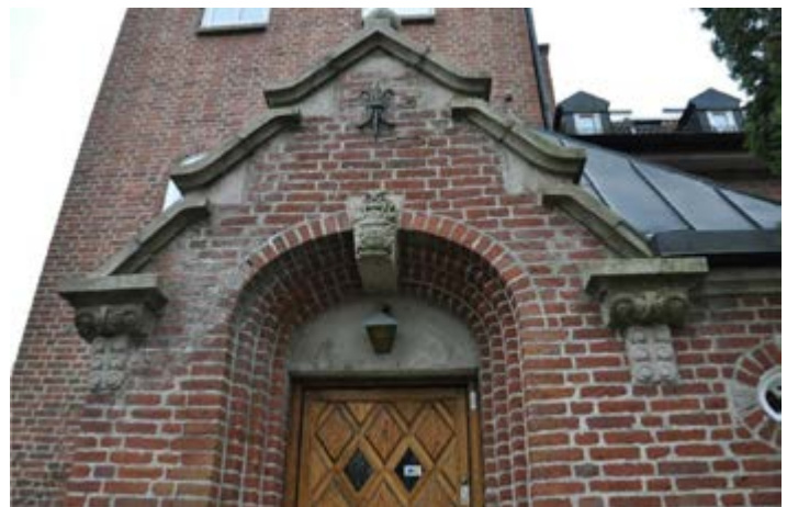
Kring entrépartiet finns några mycket fint bearbetade granitdetaljer. Under tak syns tecken på tidigare reparationer av vägg och tak.
