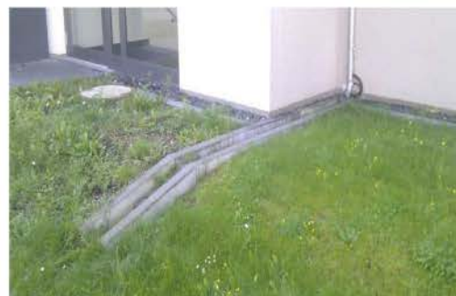
Stuprörutkastare med rännal som mynnar ut i svackdike. Foto: E. Carlsson.
