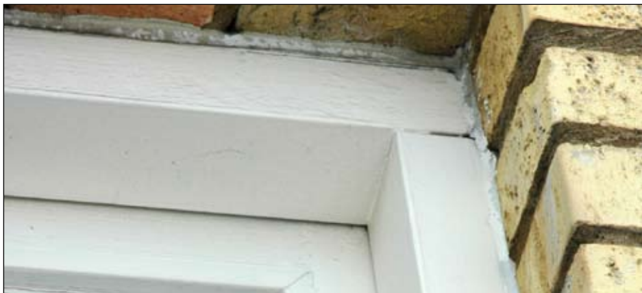
PCB i fönsterfog
