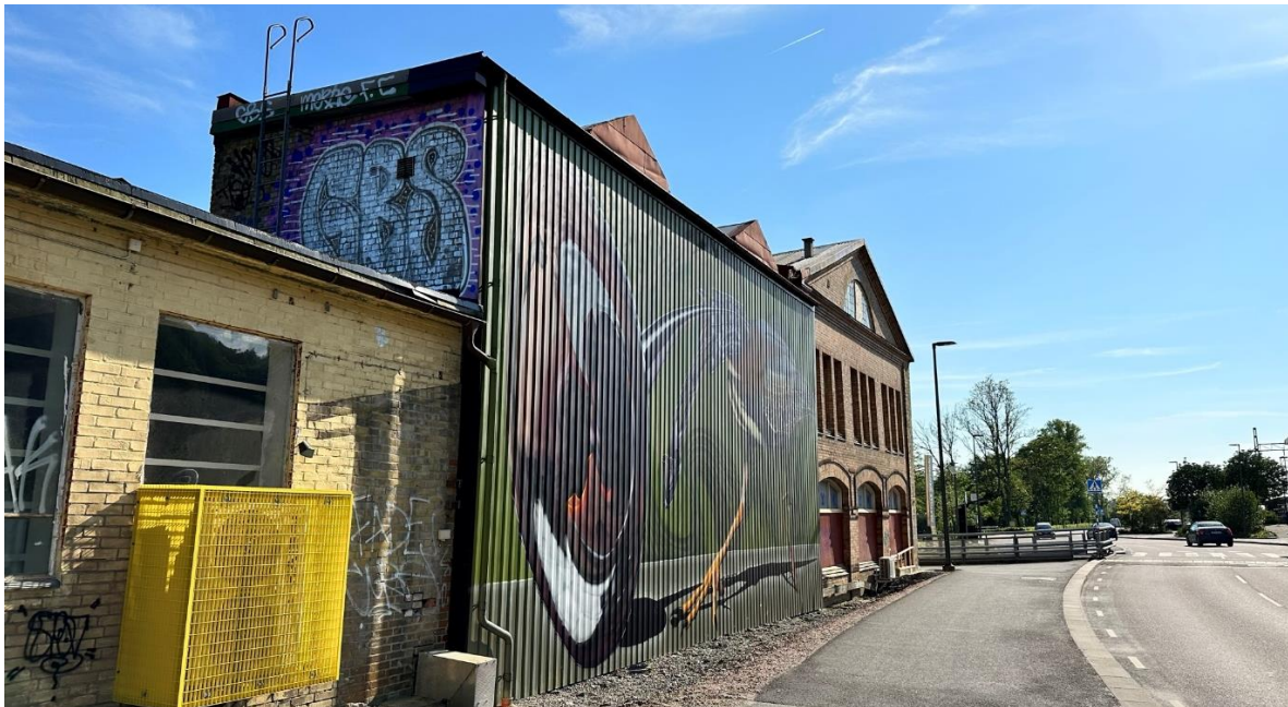
Figur 23. En bemålad plåtfasad har ersatt en delvis riven byggnad.
