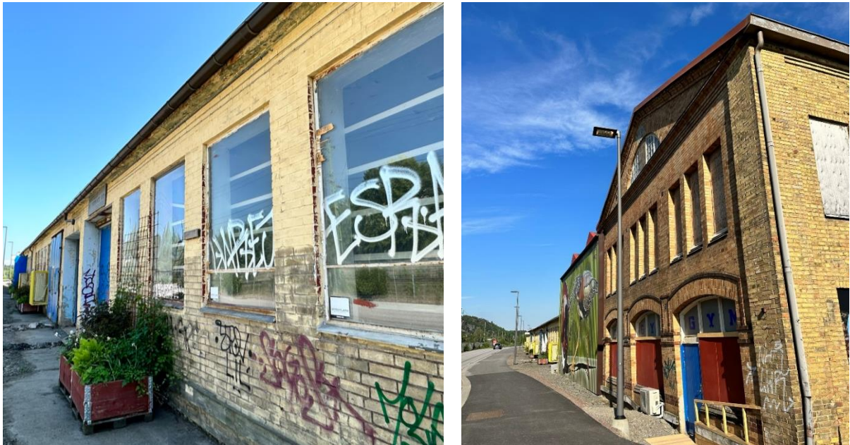
Figur 22. Fasaderna ut mot järnvägen ger idag ett brokigt, industriellt intryck. Igensatta fönster och dörrar, bemålad plåtfasad blandas med gulmålat fasadtegel och plåtdörrar i grälla färger.
