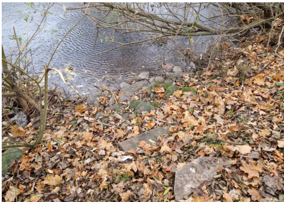
Figur 7.2. Generellt finns erosionsskydd längs med Säveåns stränder. Figuren visar exempel på ett parti med sämre kvalitet. (Foto Rejlers AB)
