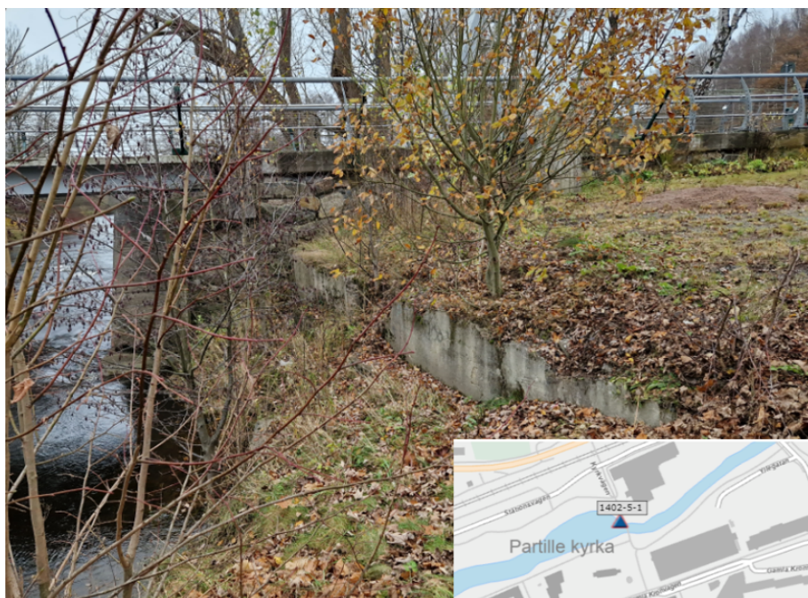
Figur 7.1. Någon typ av betongkonstruktion / stödmurskonstruktion i anslutning till befintlig bro i västra delen av undersökningsområdet. Bron har beteckningen 1402-5-1 i nationell brodatabas Batman. (Foto Rejlers AB)
